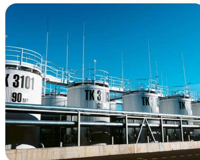
Резервуарный парк 5600 м 3
